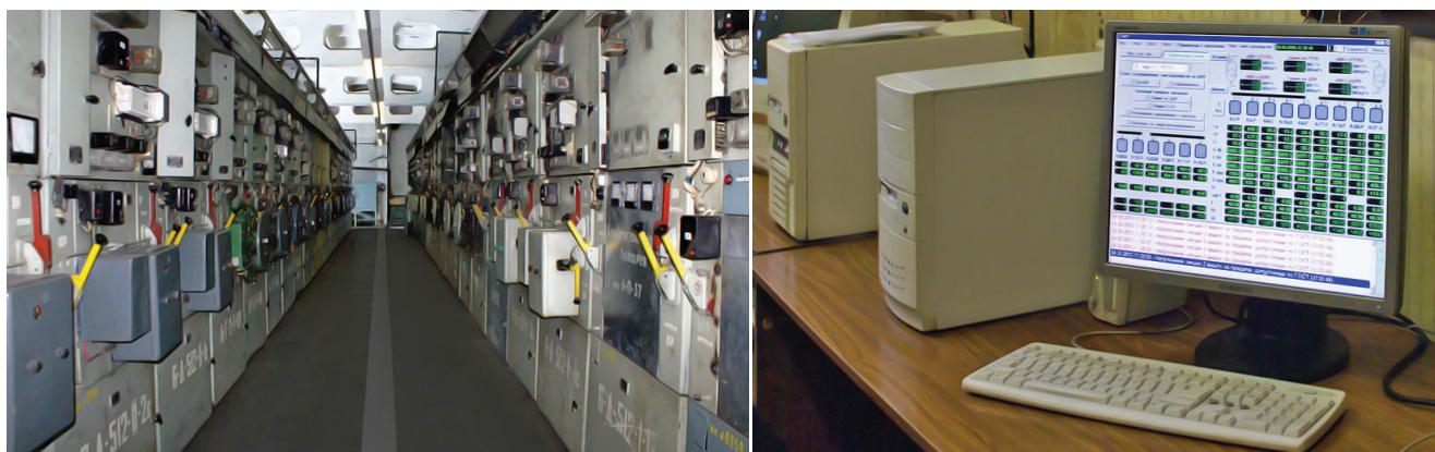
Система контроля и управления центральным распределительным пунктом 6 кВ
